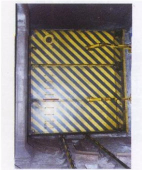
東西線内に設置されている防水ゲート。写真は閉鎖時（茅場町駅～門前仲町駅間）（写真・地下鉄博物館）
